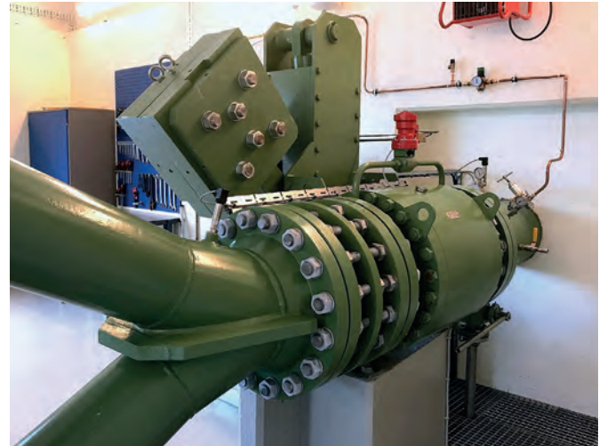
Kurek kulowy AG w elektrowni wodnej Liarelva w Norwegii
